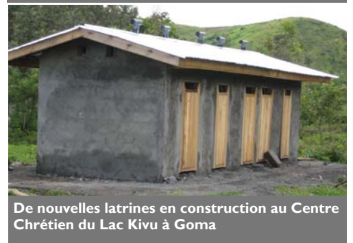
De nouvelles latrines en construction au Centre Chrétien du Lac Kivu à Goma
